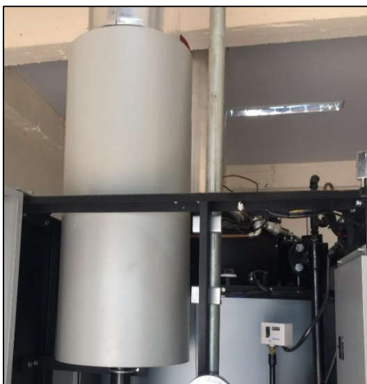
ภาพที่ 53 แสดงการตรวจสอบ Separator
