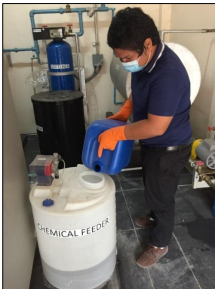
ภาพที่ 29 แสดงการเติมสารเคมีลงในถังพัก (Chemical feeder)
