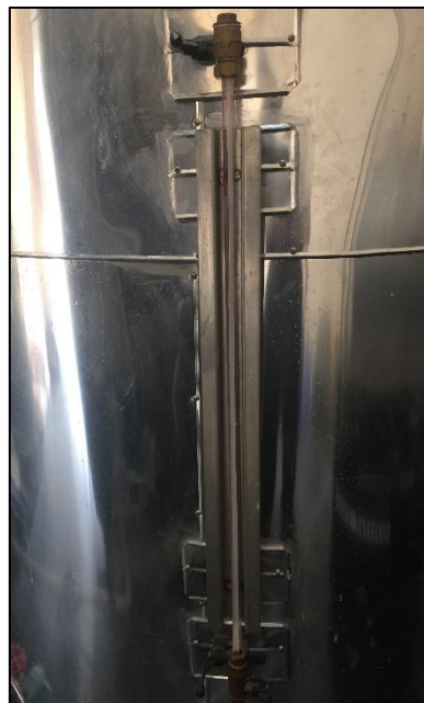
ภาพที่ 24 แสดงการตรวจสอบระดับน้ำประปาในถังพักน้ำป้อน (Feed water tank)
