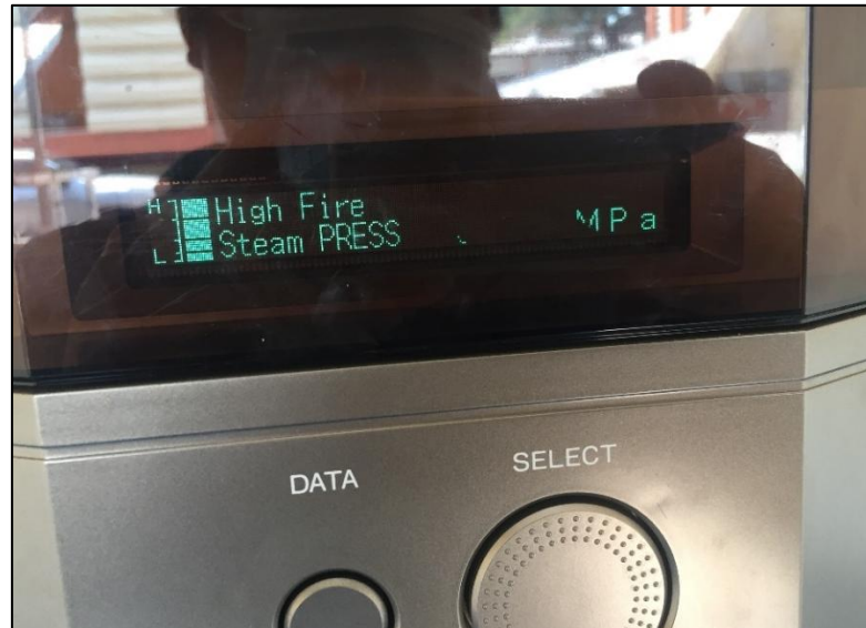
ภาพที่ 20 แสดงการตรวจสอบไฟแสดงผลสถานะพร้อมทำงาน ของเครื่องกำเนิดไอน้ำ (Boiler)
