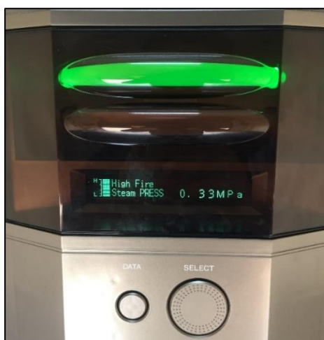
ภาพที่ 56 แสดงการหน้าจอบูตควบคุมการทำงานของเครื่องกำเนิดไอน้ำ (Boiler)
