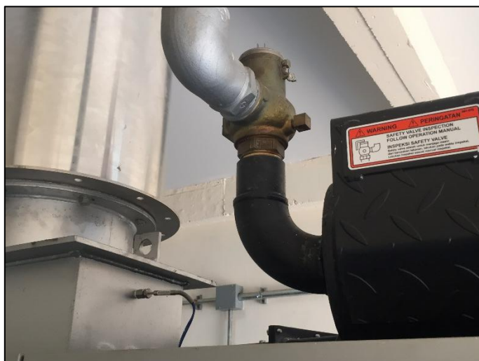
ภาพที่ 47 แสดงการตรวจสอบ Safety valve
