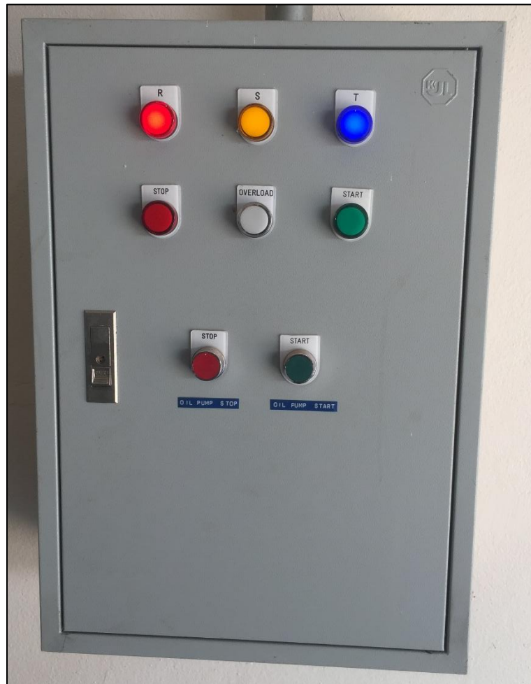
ภาพที่ 18 แสดงการตรวจสอบกระแสไฟฟ้าก่อนจ่ายเข้าระบบ
