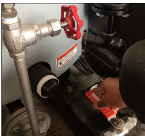
ภาพที่ 45 แสดงการตรวจสอบ Blow down valve
