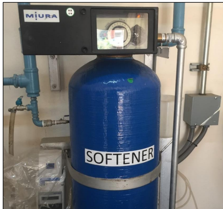
ภาพที่ 21 แสดงการตรวจสอบไฟแสดงผลสถานะพร้อมทำงานของเครื่องทำน้ำอ่อน (Softener)
