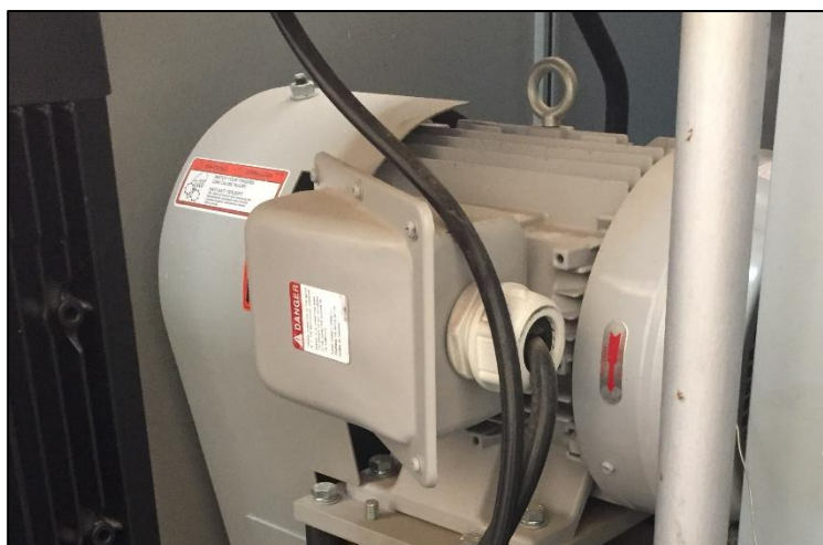
ภาพที่ 48 แสดงการตรวจสอบ Damper motor
