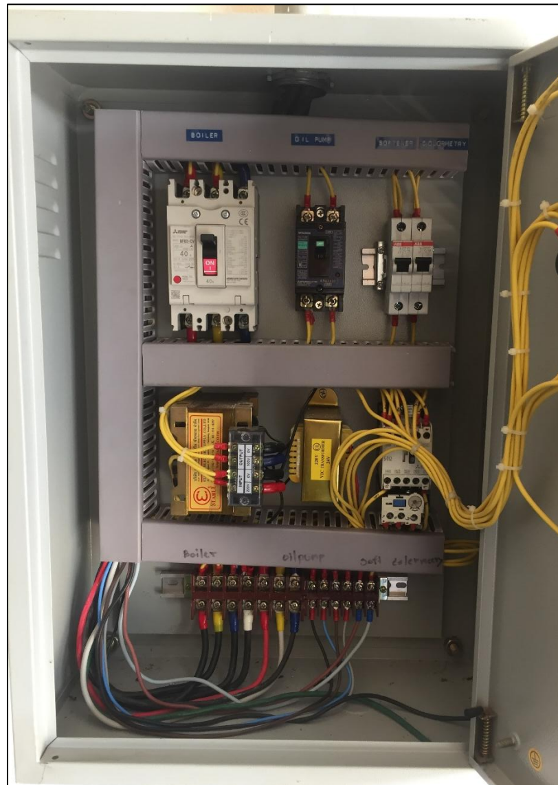
ภาพที่ 19 แสดงการเปิดเบรกเกอร์เพื่อจ่ายกระแสไฟฟ้าเข้าระบบที่ตู้ Control panel
