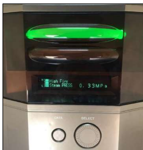
ภาพที่ 56 แสดงการหน้าจอชุดควบคุมการทำงานของเครื่องกำเนิดไอน้ำ (Boiler)
